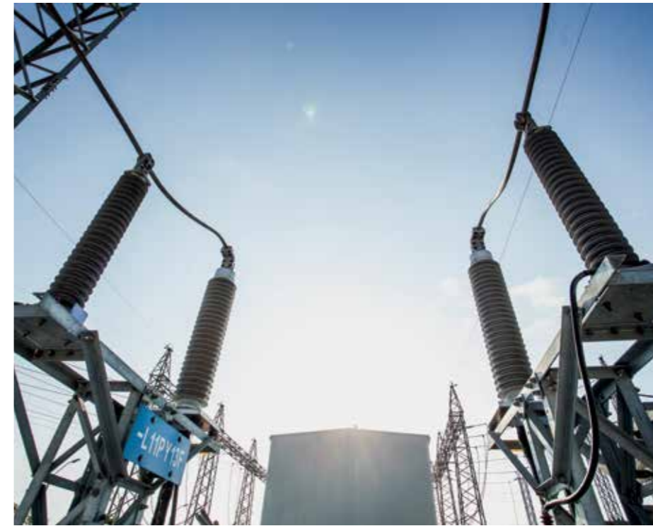
Subestación Cuestecitas La Guajira, Colombia
